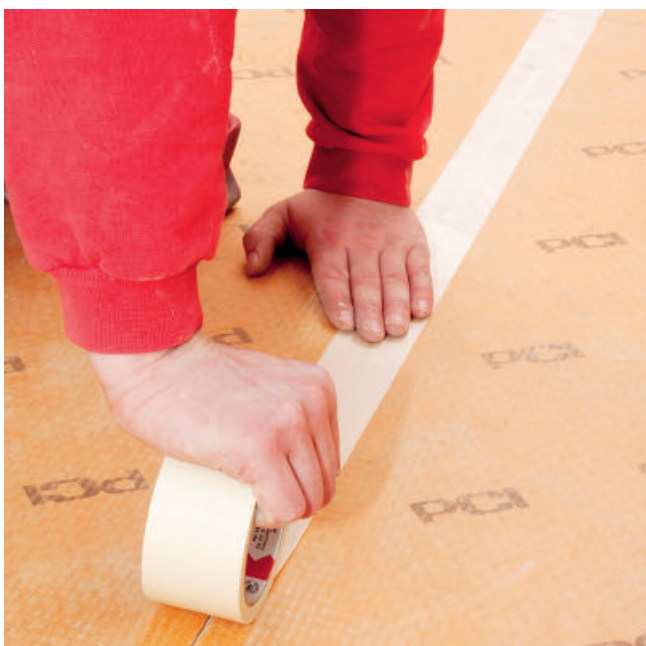
In Trockenbereichen die Stöße mit Kreppband sichern, in Bereichen mit Feuchtigkeitsbelastung mit PCI Pectape abdichten...
